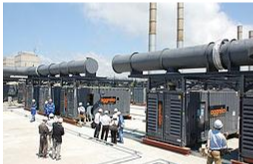
北海道電力 苫小牧火力発電所 74MW (出展: 苫小牧民報社)
