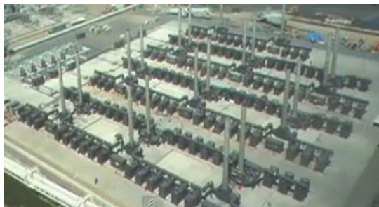
東京電力 常陸那珂発電所 100MW
