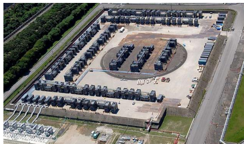
東京電力 袖ヶ浦発電所 100MW(ガス)
