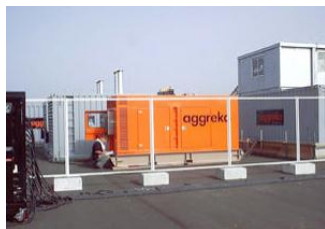
大分 設置状況
