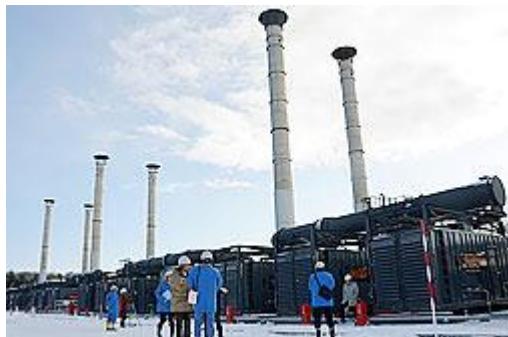
北海道電力 南早来変電所 74MW (出展: 苫小牧民報社)
